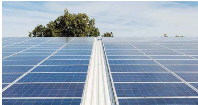
Nantes Habitat diversifie les modes de chauffage. Ici, des panneaux photovoltaïques.
